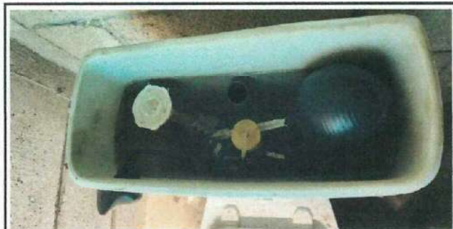
Foto 5: se necesita cambio de accesorios de sanitarios
