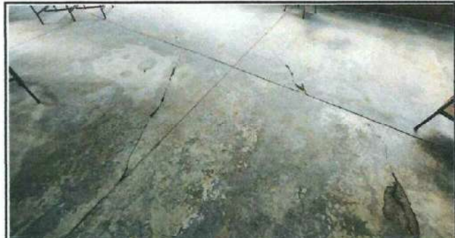
Foto 4: se necesita la sustitucion de piso de concreto
