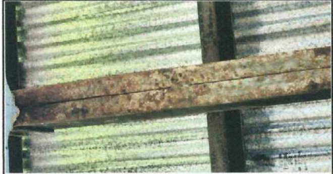
Foto 2: Se necesita dar mantenimiento a estructura de techo
