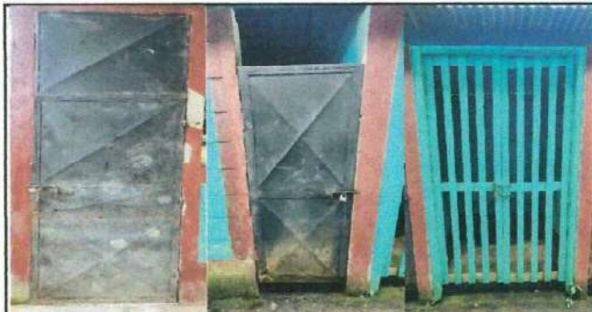
Foto 3: se necesita dar mantenimiento a 4 puertas de aulas, 4 puertas de baños y susticion de puerta madera a metal de lavamanos
