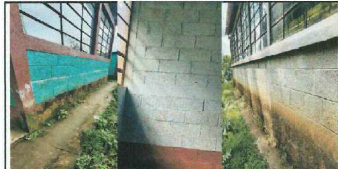
Foto 6: se necesita repello en paredes que presentan fisuras, asi mismo pintura para Interior y exterior
