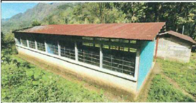
Foto1: Se necesita cambio de cubierta de lamina e instalacions de tubo pvc y bajadas de agua pluvial
